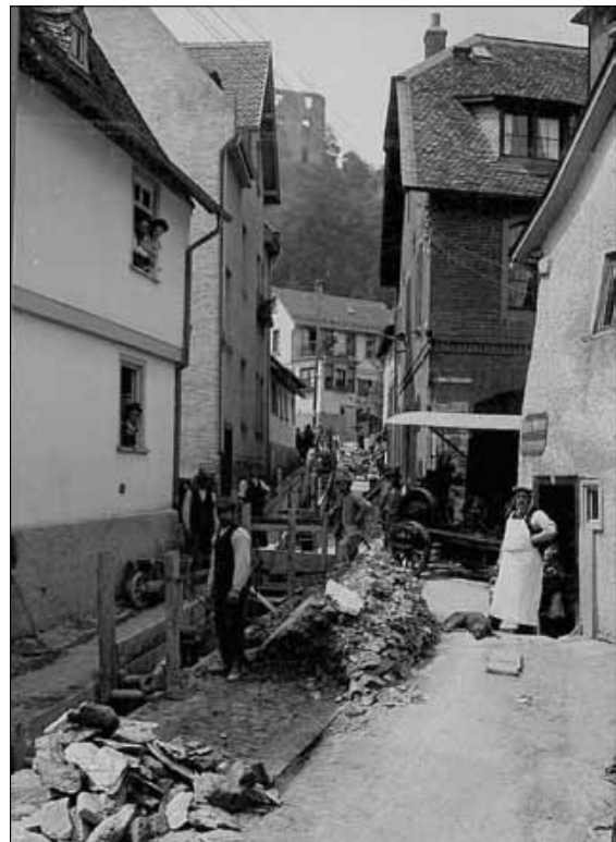
Kanalisationsarbeiten in der Kugelherrenstraße. Gut zu erkennen sind rechts das ehemalige Spritzenhaus und in der Mitte das von Ernst Ludwig Kirchner „verewigte“, mittlerweile abgerissene Haus Kugelherrenstraße 17 (Stadtarchiv Königstein, Fotoalbum)
