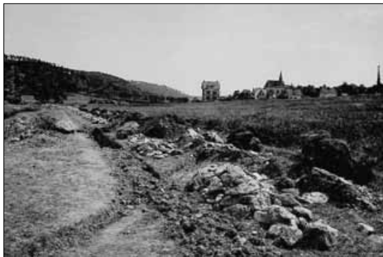
Ein Blick auf das Schneidhain von 1911, aufgenommen beim Verlegen der Rohre zur neuen Kläranlage. (Stadtarchiv Königstein, Fotoalbum)
